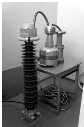
Рис. 4. Изоляционная колонна с высоковольтным делителем, трансформатором тока и измерительным модулем
