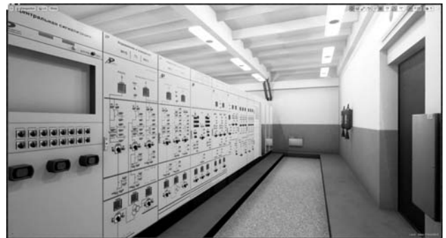
Рис. 1. Фрагмент главного щита управления общеподстанционного пункта управления
