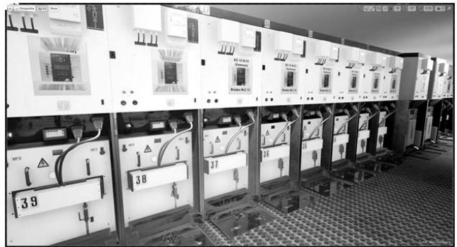
Рис. 2. Фрагмент помещения закрытого распределительного устройства в виртуальной среде
