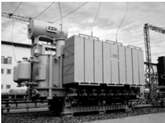
Рис. 4. Управляемый шунтирующий реактор типа РТУ-25000/35-УХЛ1 на подстанции 220/35/10 кВ «Южное Хыльчую»
