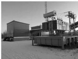
ETD «Transformatory a.s.»
